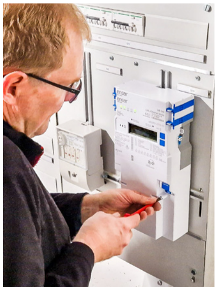
Mit dem «Smartmeter» können Strom-, Wasser- und Wärmeverbrauch aus der Distanz ausgelesen werden.
