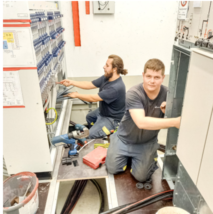
Installation in der TS Netzen Süd
