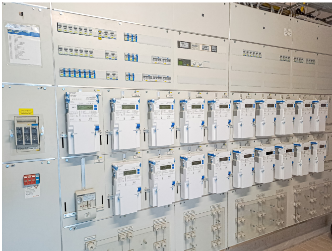
Smartmeter in einer Wohnüberbauung
