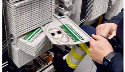
Aufschalten der Glasfasern in der Technikzentrale.
